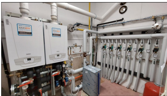
La nuova centrale termica della chiesa parrocchiale
